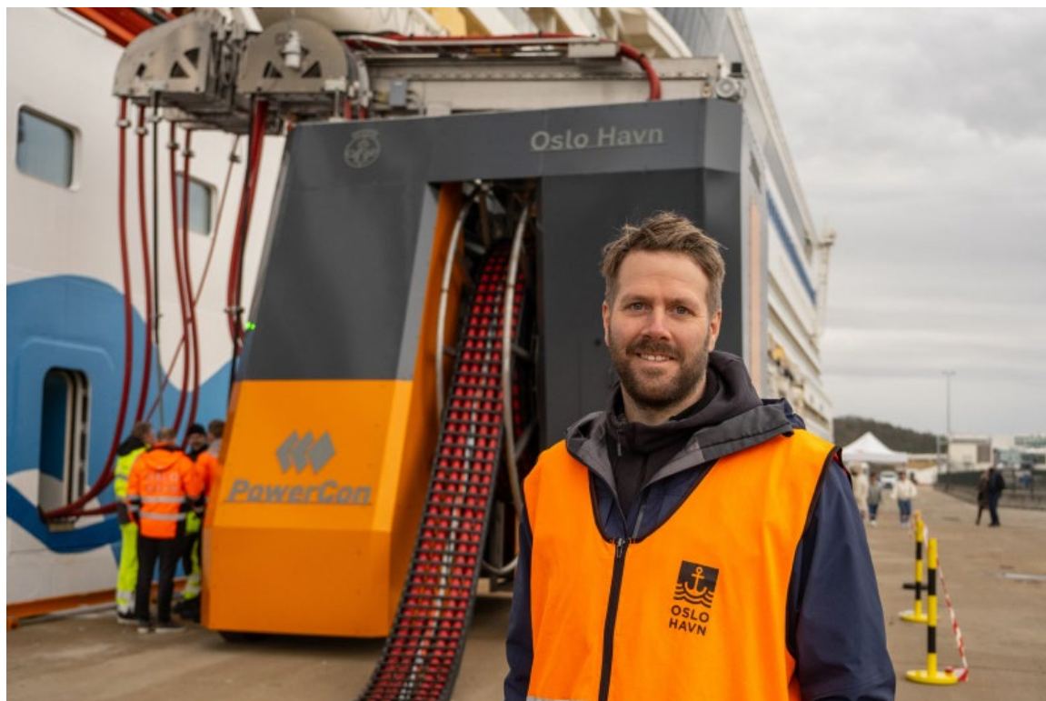
Prosjektleder Erlend Persson ved landstrømanlegg til cruise på Revierkaia 2025.
