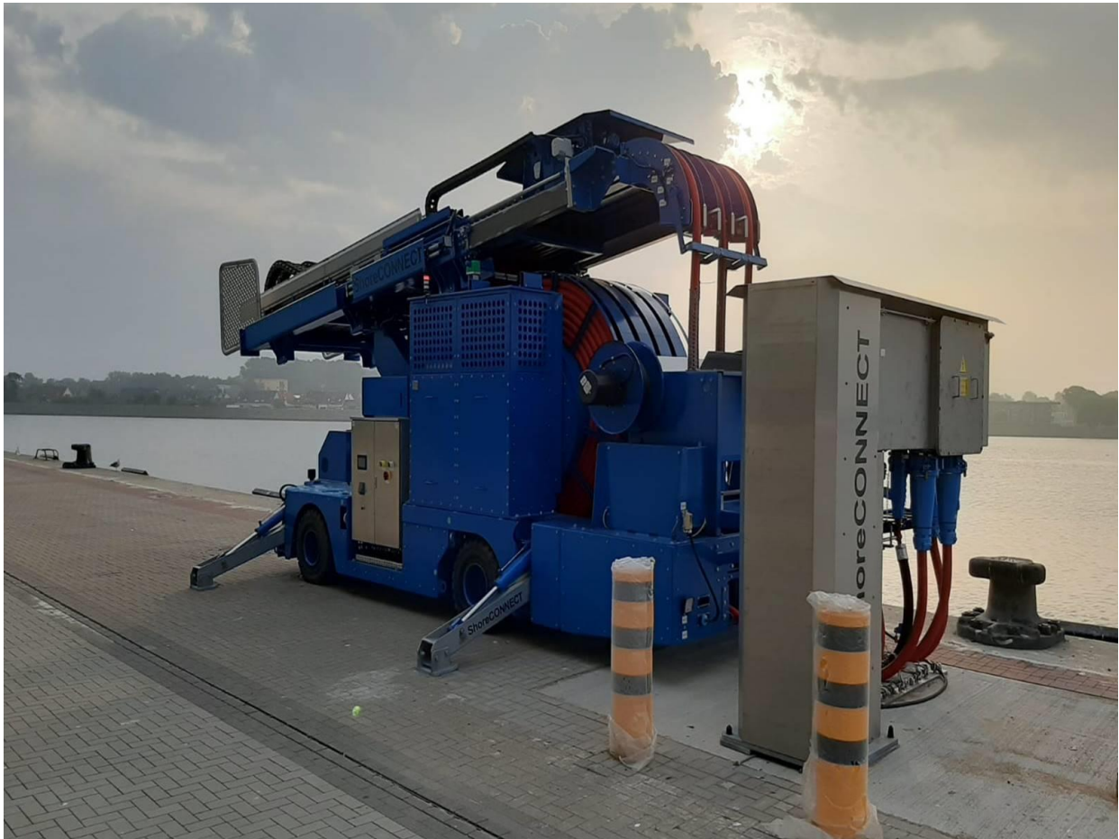
Figur 12 - Bilde av mobil kabelhåndtering og kaiskap fra Wabtec i Rostock havn.
