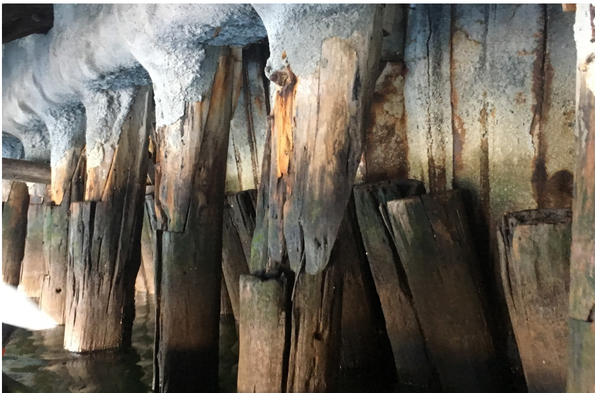
bilde 2: Bærende konstruksjon under kai på Akershusutstikker før oppgradering; trepeler
