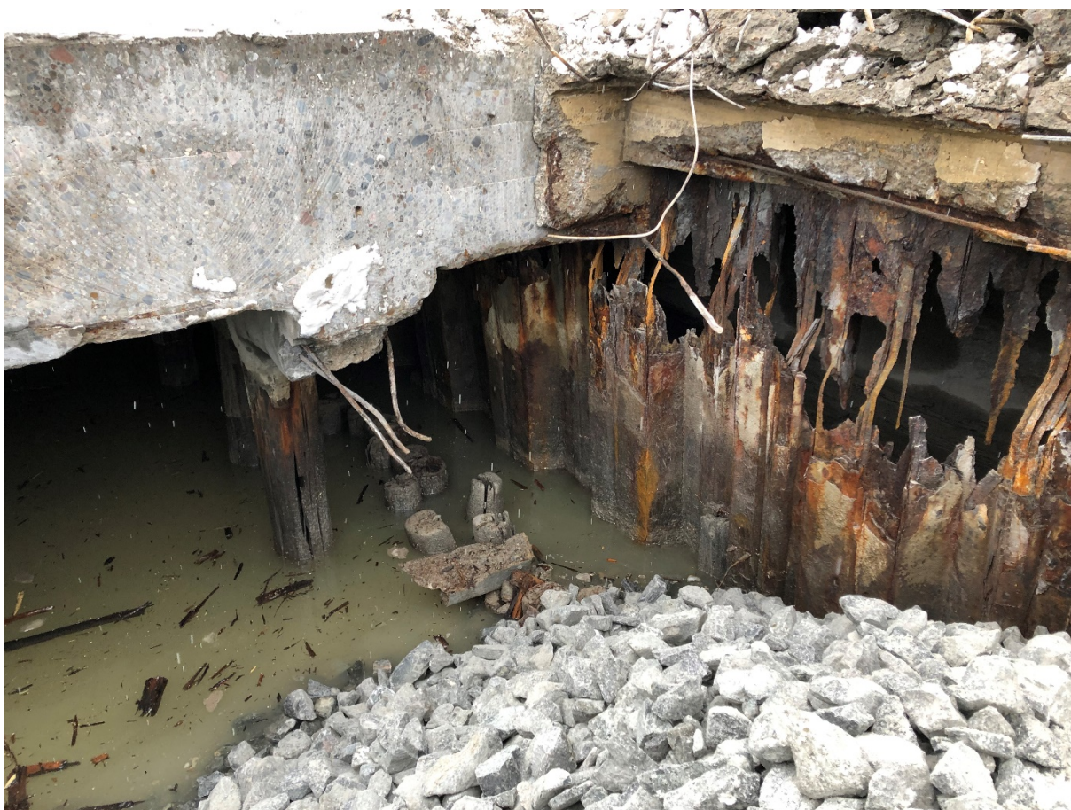
bilde 3: Gjennomkorrodert spuntvegg under kai på Akershusutstikker før oppgradering
